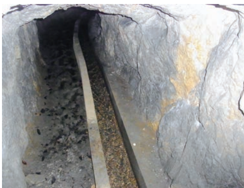
羽山発電所の導水路隧道。長さ1km以上に及ぶトンネルは地元の鉱夫の手掘りと伝えられています。
