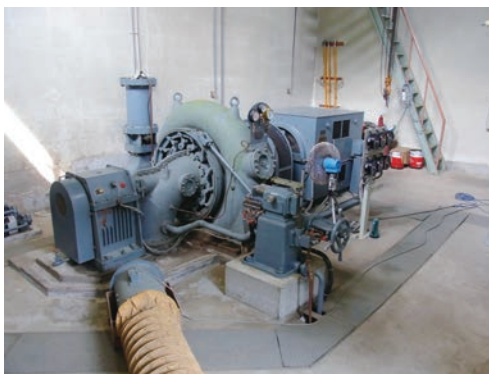
フランス水車発電機。この発電機を製造した広島県の水車メーカー・イーラム工業は、安価な水車の製造やメンテナンスサービスの提供を通じて、中国地方における小水力発電の普及に多大な貢献をしました。
